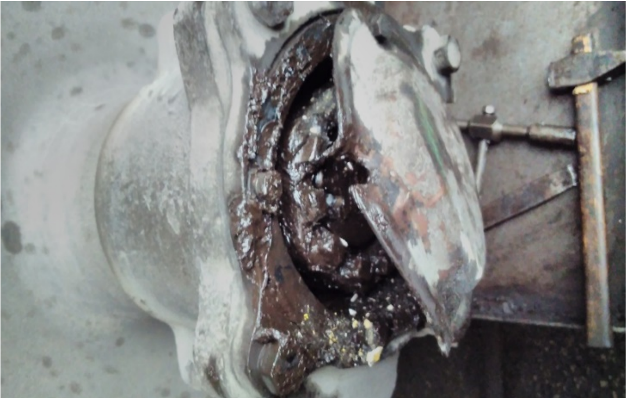
Рис. 33 Руйнування торцевого кріплення та оглядової кришки
